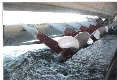
Turbinerna på ett tidvattenkraftverk i Nederländerna
