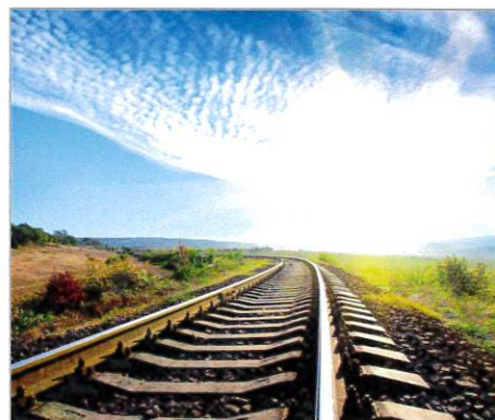
Under heta sommardagar kan järnvägsrälsen bli så varm att den utvidgar sig. Det kan då bildas solkurvor .
